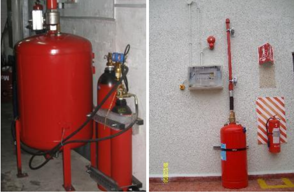
Fotoğraf 3 1: Kuru Kimyevi Tozlu Yangın Söndürme Sistemleri
