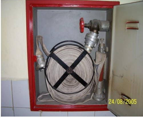
Fotoğraf 2.3: Vana kontrollü yangın dolabı
