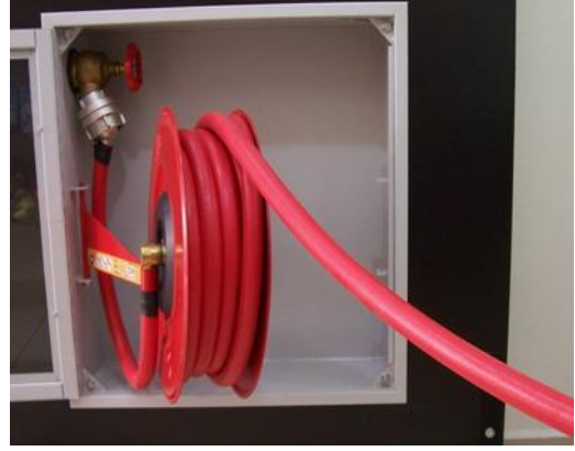
Fotoğraf 2.4: Lans (fiskiye) kontrollü yangın dolabı
